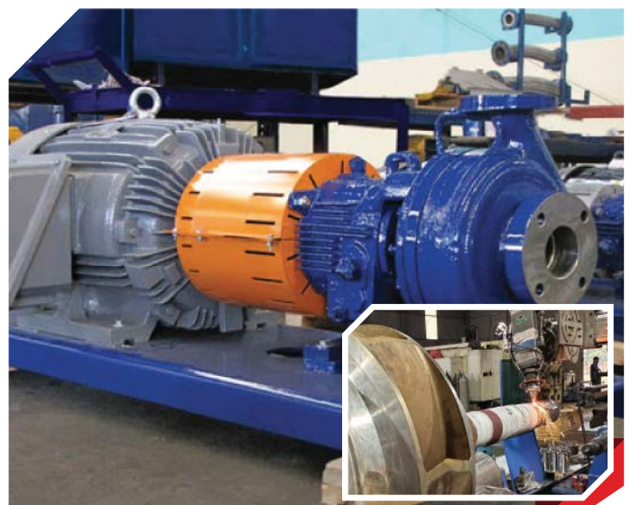
Bơm cấp nước nhà máy nhiệt điện
