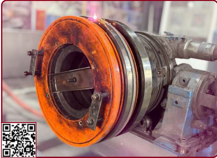
Cổ góp nhà máy thủy điện
